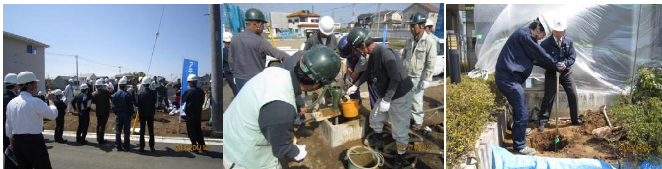
社員勉強会の様子(左写真)、器具の設置、動作確認は専門家チームで実施(中央写真)、当社事務所敷地内での掘削作業(右写真)
